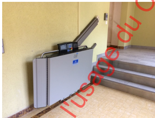
C.Gravelone / Plateforme élévatrice
