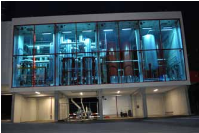
Chaufferie de secours
